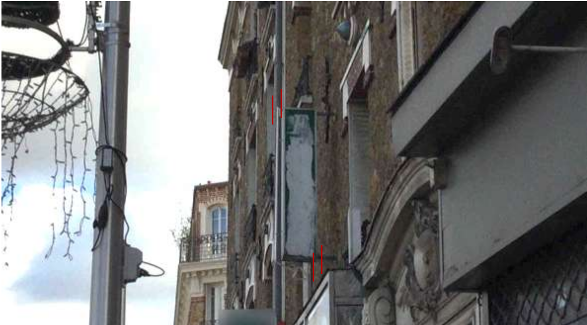
Enseignes perpendiculaires en mauvais état – Saint-Maur-des-Fossés – 2019
