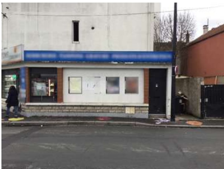
Micro affichage en mauvais état d'entretien – Champigny-sur-Marne – 2019
