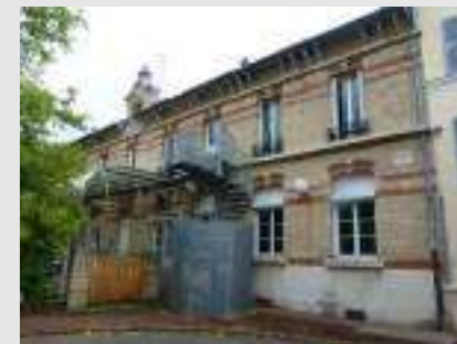
École maternelle Mot : le premier étage offre encore une composition et un traitement préservé des matériaux, tout comme le débord de la toiture mettant en évidence des éléments de charpente.
