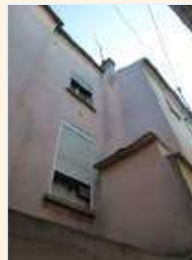
Passage privé Place du Général Leclerc : Enduit ciment et store en PVC.
