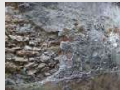
Pathologies : forte dégradation de certains enduits, révélant l'appareil de moellons.
