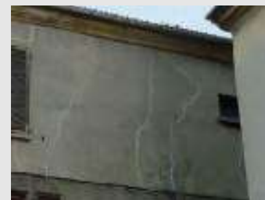
Pathologies : la mise en œuvre d'enduits ciment vient altérer les façades : infiltration d'eau, fissures.
