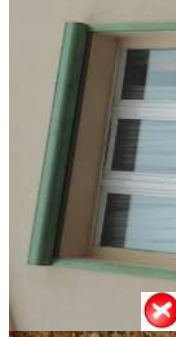
TRAVAUX INADAPTÉS : Coffre de volet saillant en façade et coloré dans une teinte différente des fenêtres.
