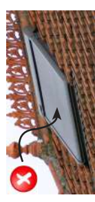
TRAVAUX INADAPTÉS : Châssis de toit saillant
