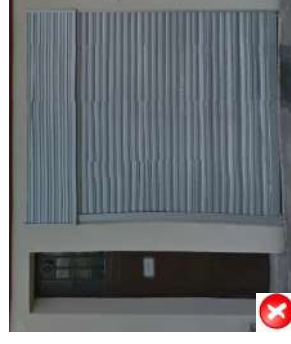
TRAVAUX INADAPTÉS : - porte et habillage de coffre métallique brut ; - trame horizontale ; - pas d'intégration par rapport au bâti existant.
