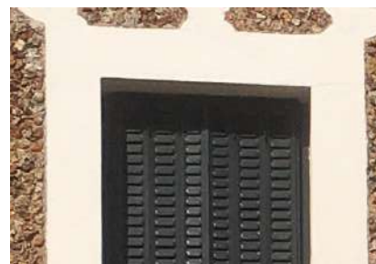
Volets pliants métalliques
