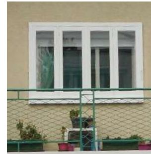
✘ Profils PVC larges. Pose en applique au nu extérieur. Ouvrants trop nombreux.
